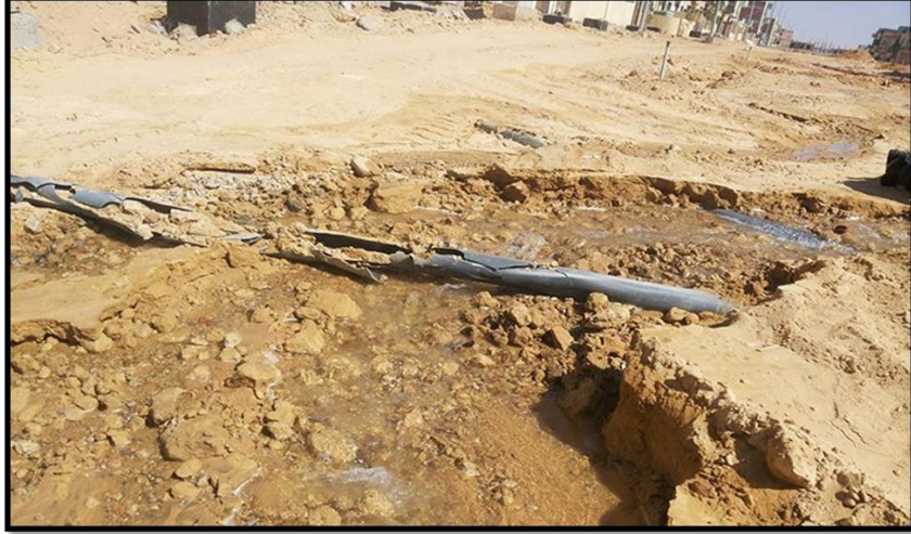
صورة (٧) توضح انفجار مواسير المياه بمشروع ابني بيتك في حي جنوب طريق الواحات ٢٠١٥/٥/١٦.
